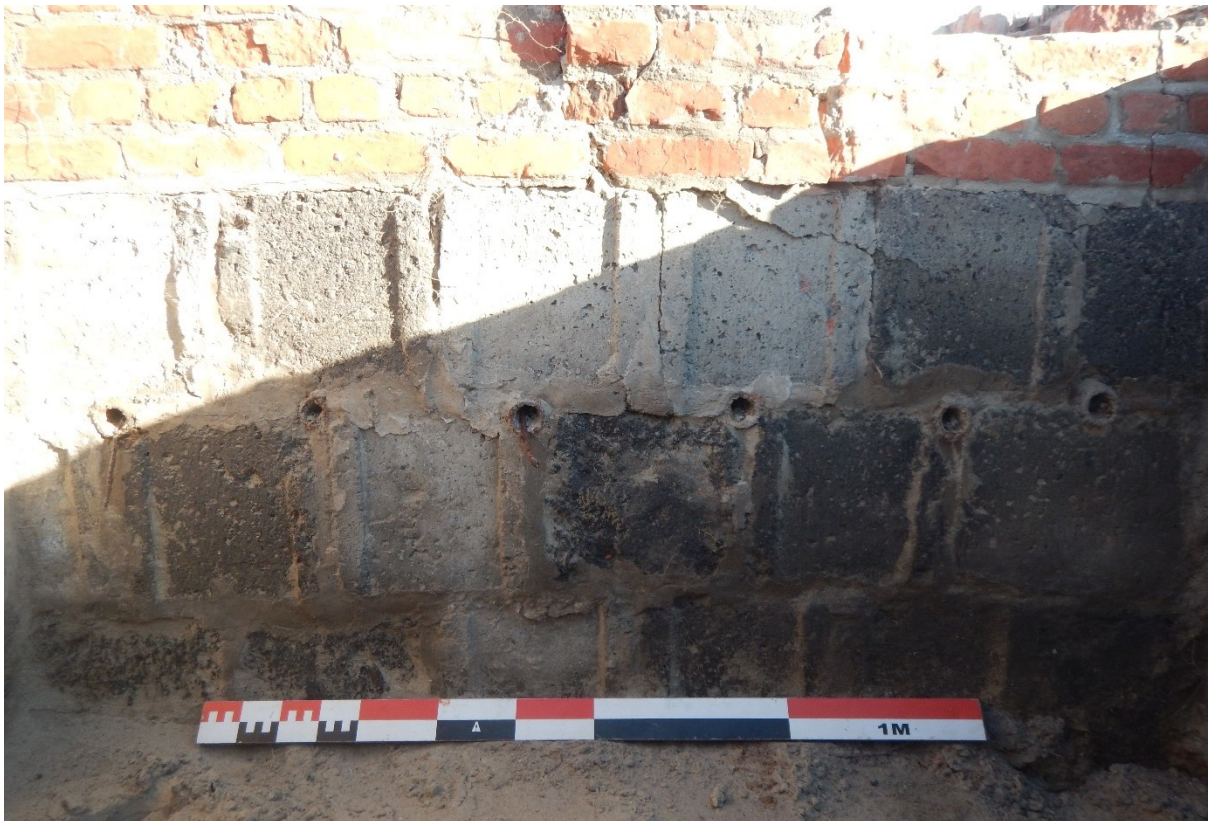
Fig. 121. De noordelijke zijde met daarin 6 toegangen voor elektriciteitskabels.
