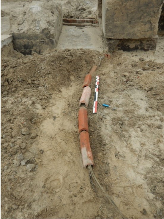
Fig. 59. Kabel die de bunker binnenkomt. Op de achtergrond de oostelijke toegang.
